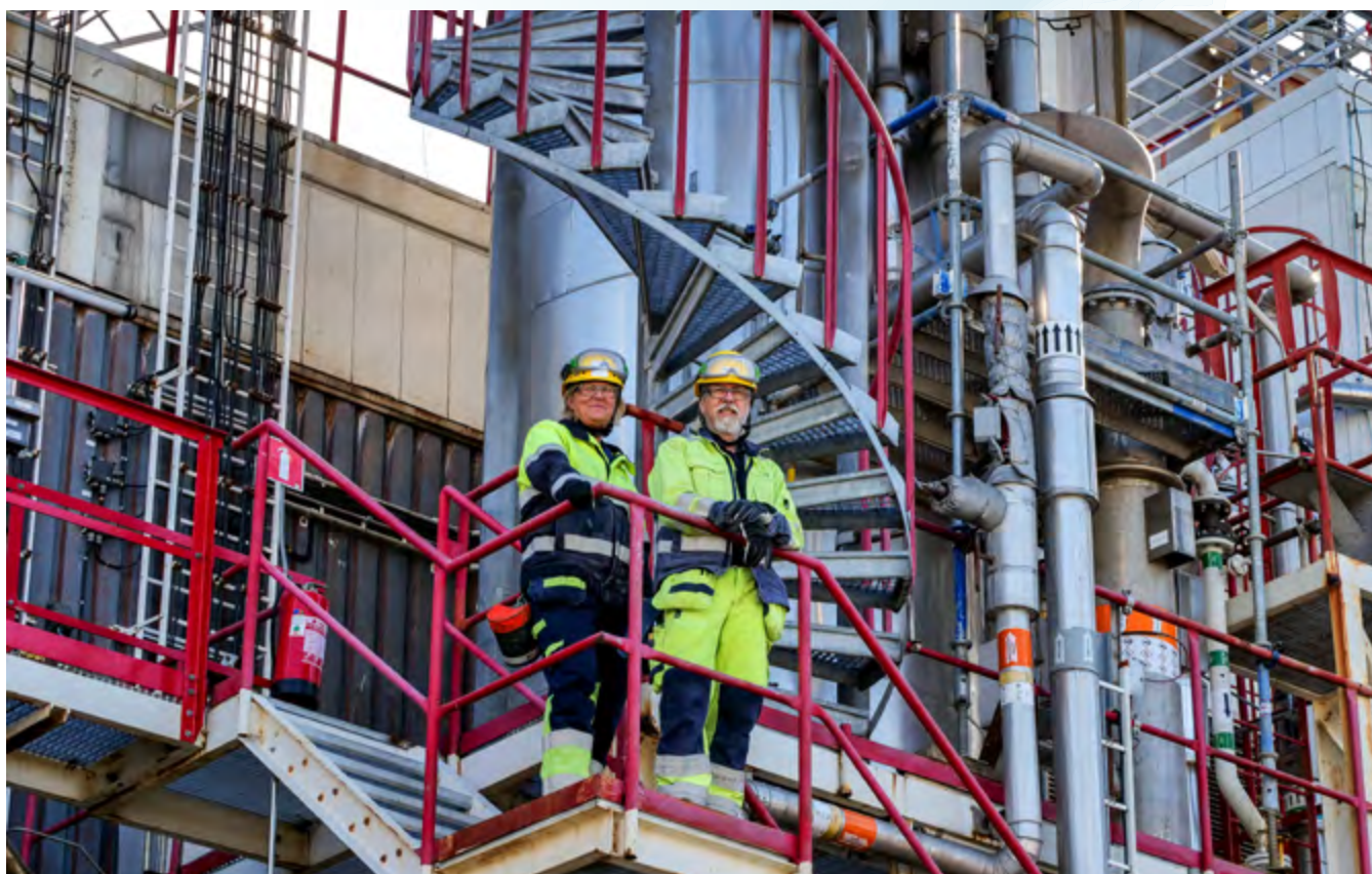
En av våra strippingkolonner som utgör ett avdrivningssteg för oreagerad VCM.
